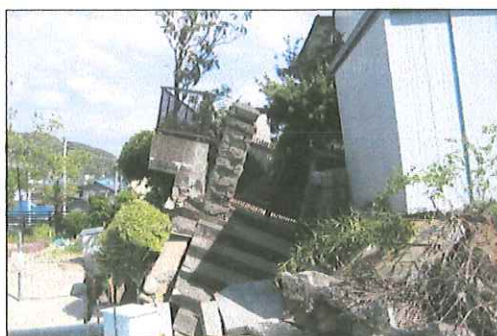
太白区青山2丁目の宅地崩落
